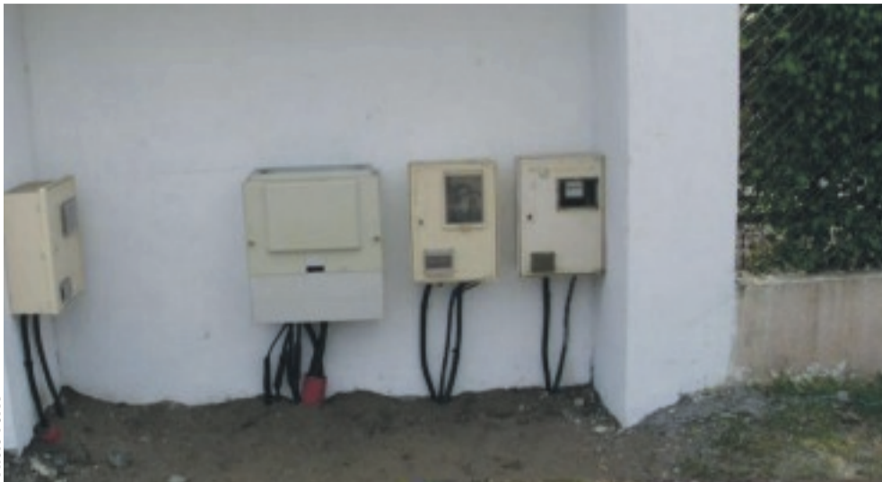
Les compteurs électriques, désormais à l'abri des intempéries.
