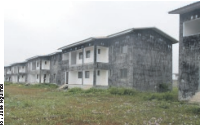
Les lots de 10 bâtiments de 4 logements R+1 non livrés par l'entrepreneur malien.
