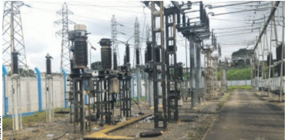
Les débris au sol, résultant de l'explosion du poste source de Bissegue dans la nuit du 16 au 17 février 2016.
