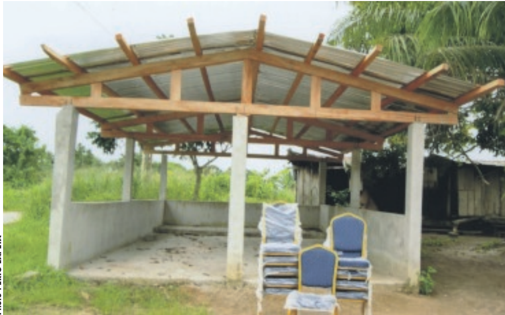
Il a également mis des hangar sà la diposition des chefferies, à l'exemple de celui-ci.
