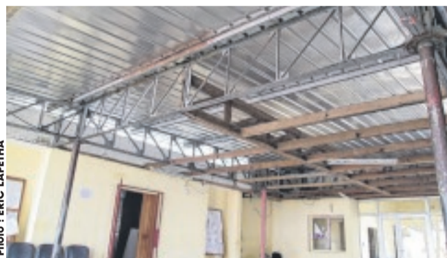
L'état dans lequel la toiture a été laissée.
