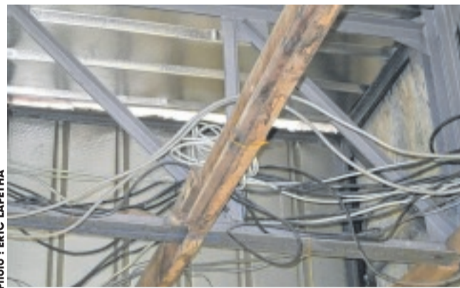
Un chantier abandonné.
