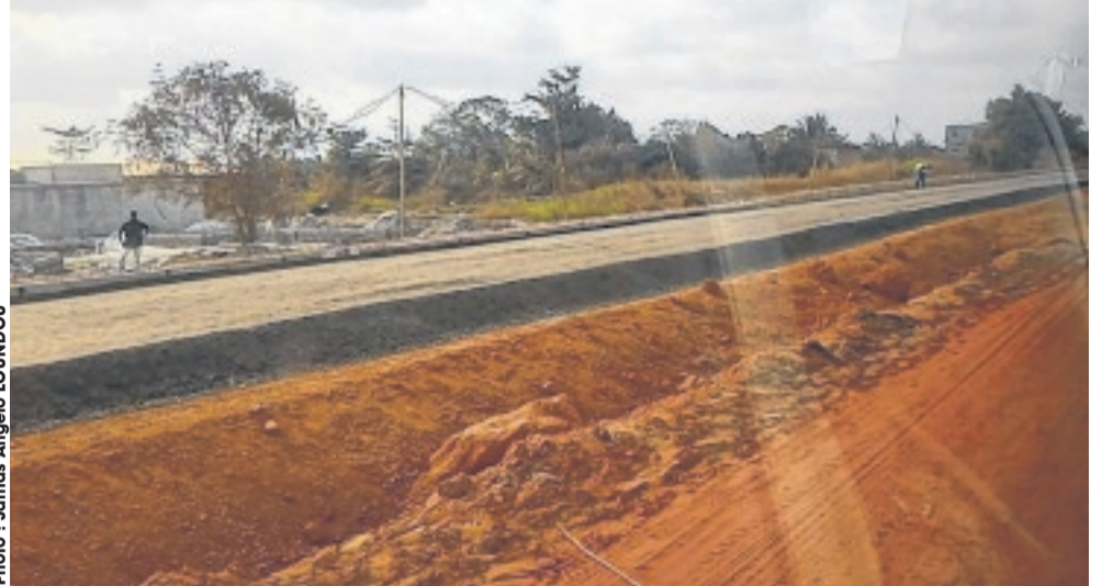
La route de 4 kilomètres qui va relier le centre-ville de Port-Gentil au stade est en construction.
