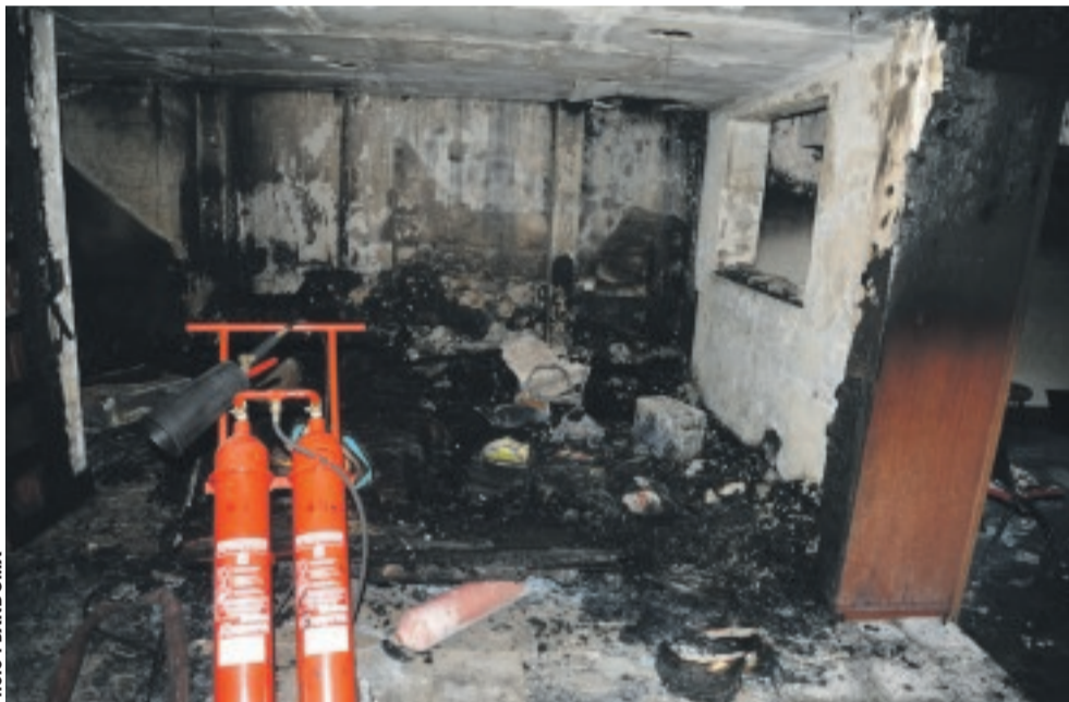
Le service d'accueil complètement calciné.
