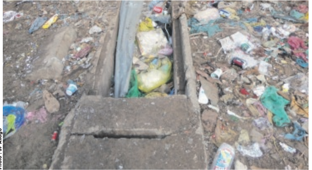
Une conduite d'eau déjà bouchée par les ordures...
