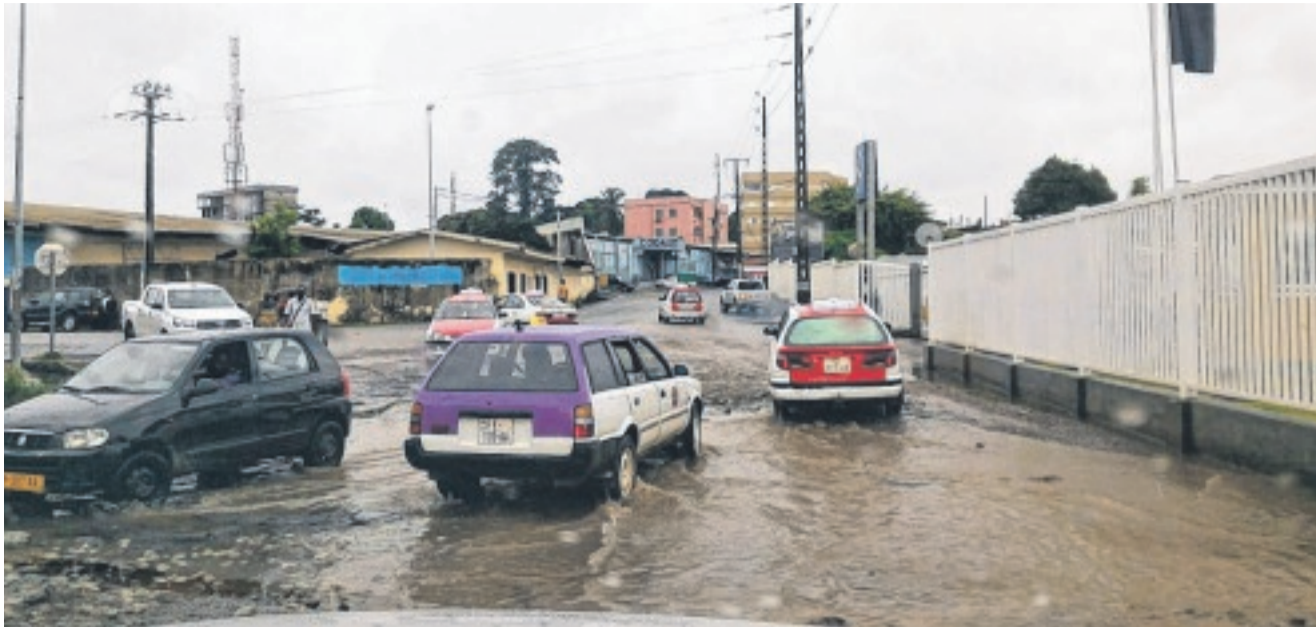
A Oloumi, en face de Tractafic, l'état de dégradation de la chaussée aggravé par les eaux stagnantes.
