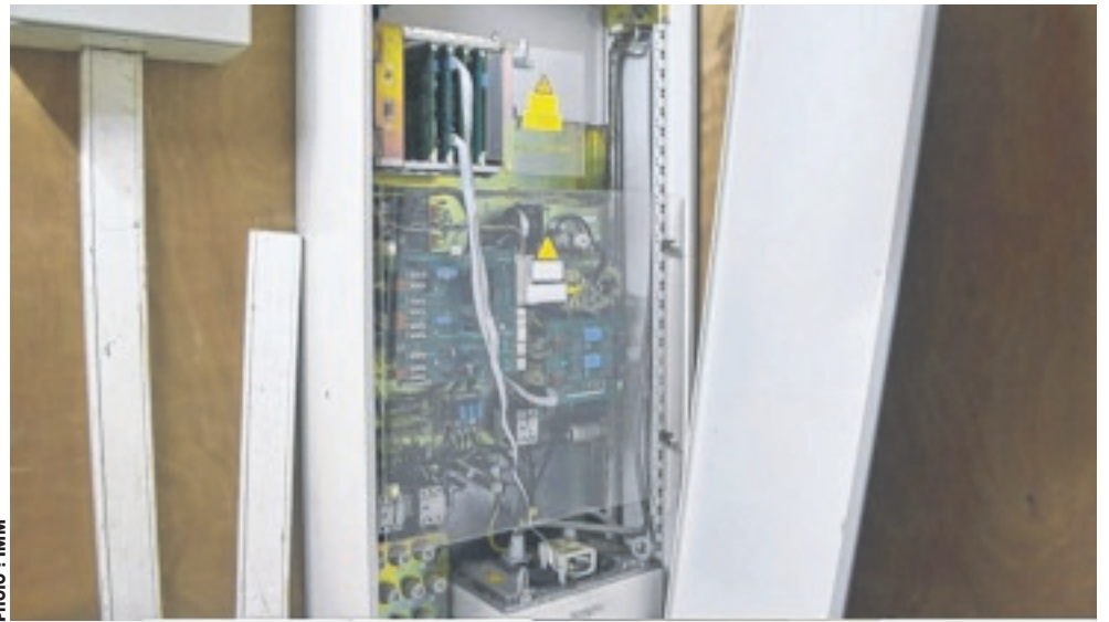
La boîte électrique endommagée par la foudre.
