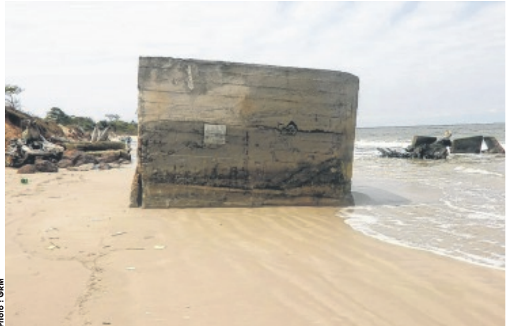
Les constructions, qui étaient à cet endroit, ont toutes été détruites par la mer qui a gagné du terrain.
