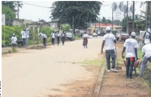
Une phase du curage des caniveaux et de nettoyage des trottoirs au deuxième arrondissement.
