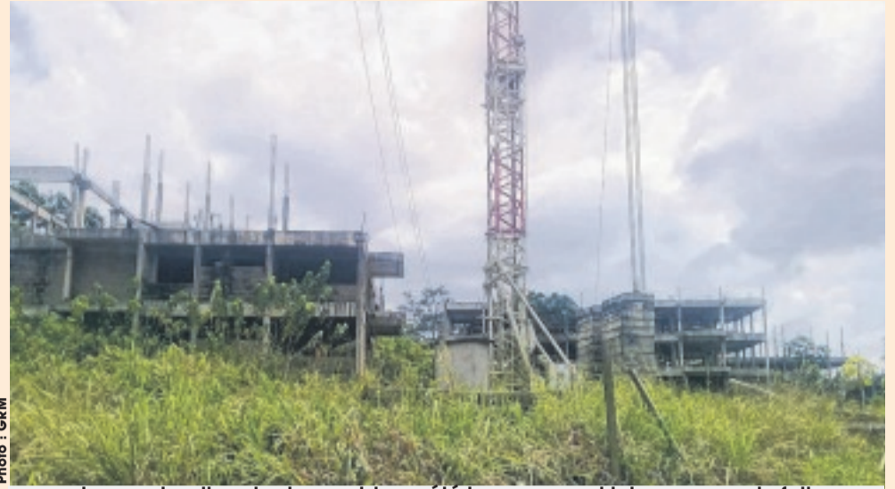
La construction des immeubles a été brusquement interrompue, du fait des détournements massifs des fonds.
