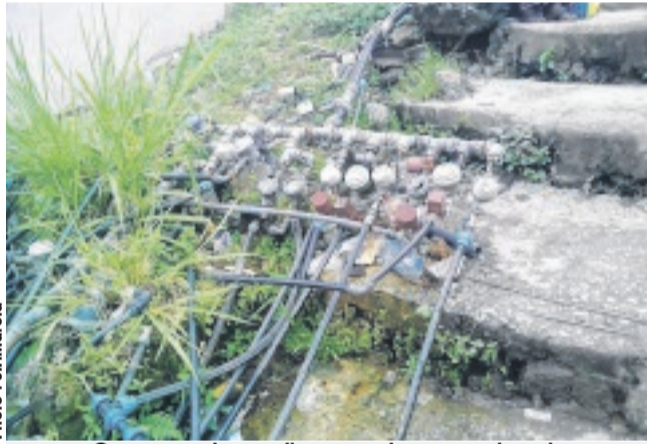
Ces compteurs d'eau sont au sec depuis de nombreuses années.
