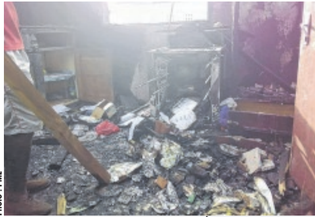
Le service des consultations après le passage du feu.
