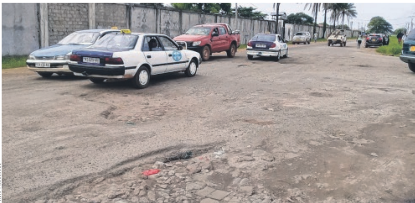
La route dégradée devant la grande maison d'arrêt de Port-Gentil.
