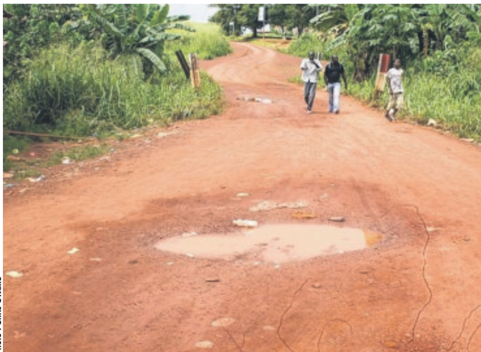
La route principale de Nsia est dégradée, à partir du carrefour TP.
