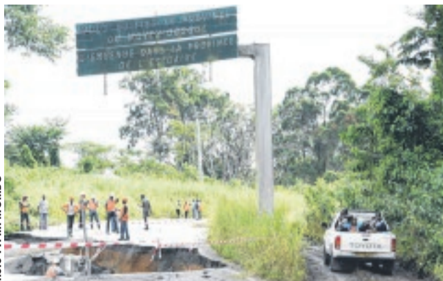
Après l'effondrement de la route, un passage de fortune a été ouvert à côté pour faire passer les usagers.
