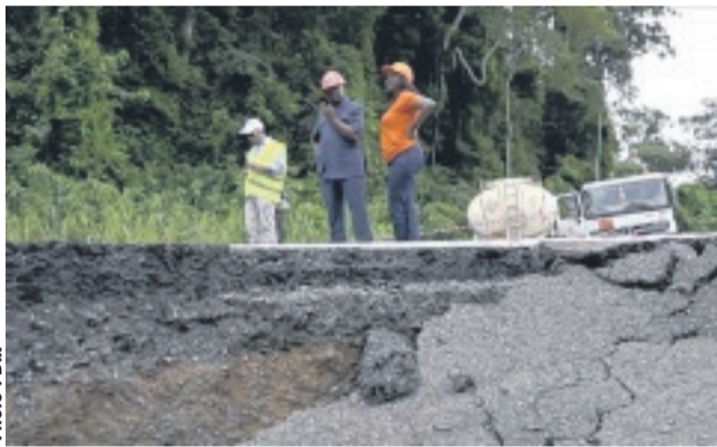
Le ministre des Infrastructures, Christian Magnagna, et ses collaborateurs à Bifoun pour constater les dégâts.
