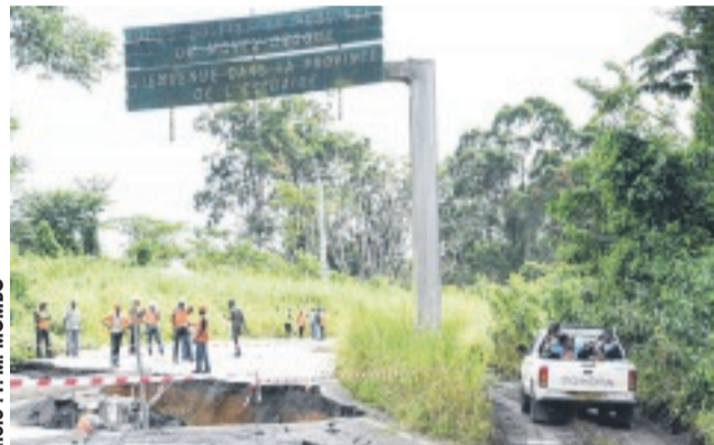
Après l'effondrement de la route, un passage de fortune a été ouvert à côté pour faire passer les usagers.
