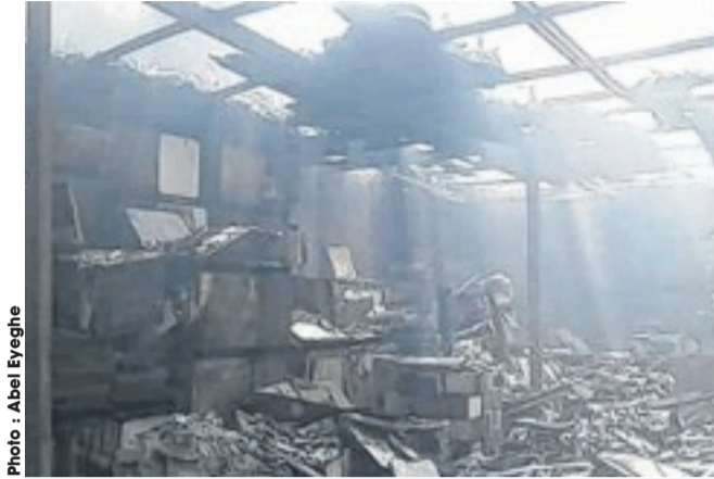
Les dégâts sont d'une grande ampleur.
