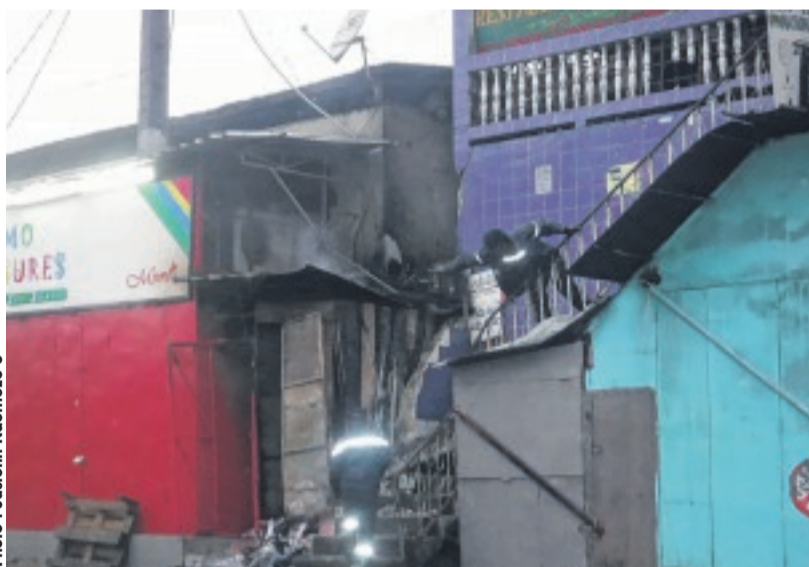
Le compartiment des compteurs d'électricité d'où est parti le feu.
