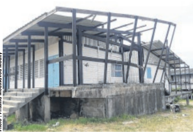
Le bâtiment P de LPIG dans un état de dégradation avancée.
