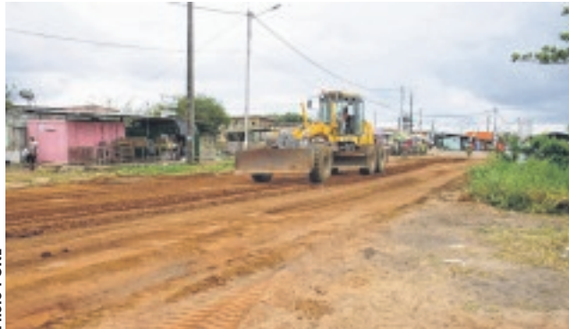
Sur le terrain, Soco-TP s'active pour livrer tous les chantiers avant le retour des grandes pluies.
