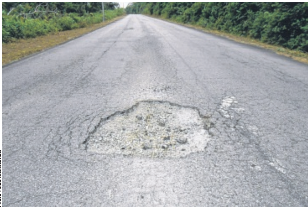
Ce type de crevasse est à l'origine de cet accident.
