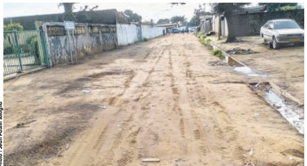
Ici également, les travaux engagés sur ce tronçon ne sont pas allés à leur terme.
