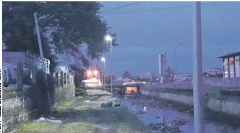
Vue des lampadaires solaires installés le long du canal de Batavea.
