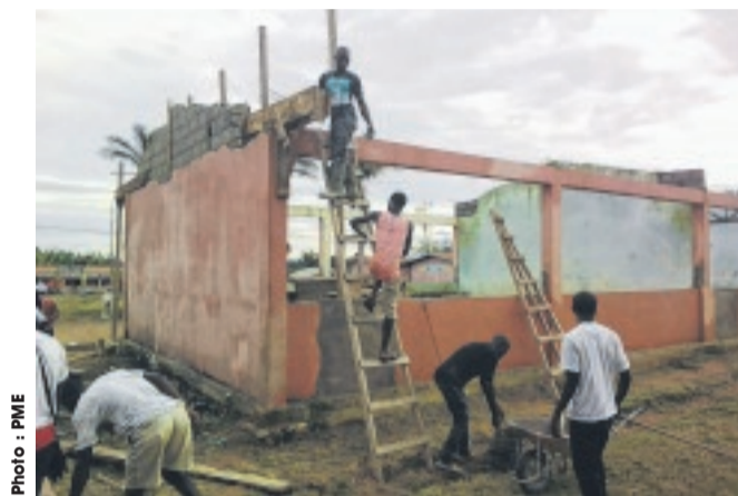
A l'initiative de la ministre, ces ouvriers s'attellent à réhabiliter le bâtiment endommagé.
