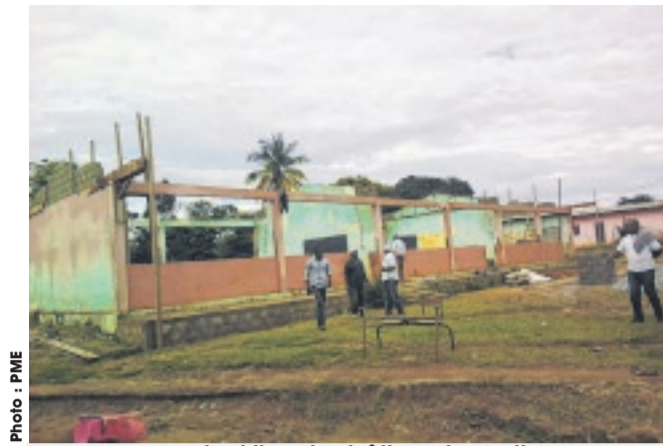
... dont l'un des bâtiments avait perdu sa toiture.
