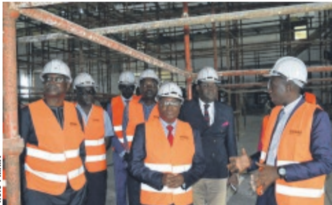
Le ministre d'Etat à l'Enseignement supérieur, Jean de Dieu Moukagni Iwangou (c), écoutant les explications du chef de l'entreprise chargée de l'exécution des travaux. Photo de droite : Les travaux de réhabilitation de cet auditorium devraient s'achever en mars prochain.
