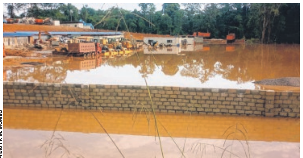
Le retard dans le démarrage des travaux n'a pas épargné l'entreprise adjudicataire elle-même dont la base vie a été totalement inondée lors de la dernière grande pluie.
