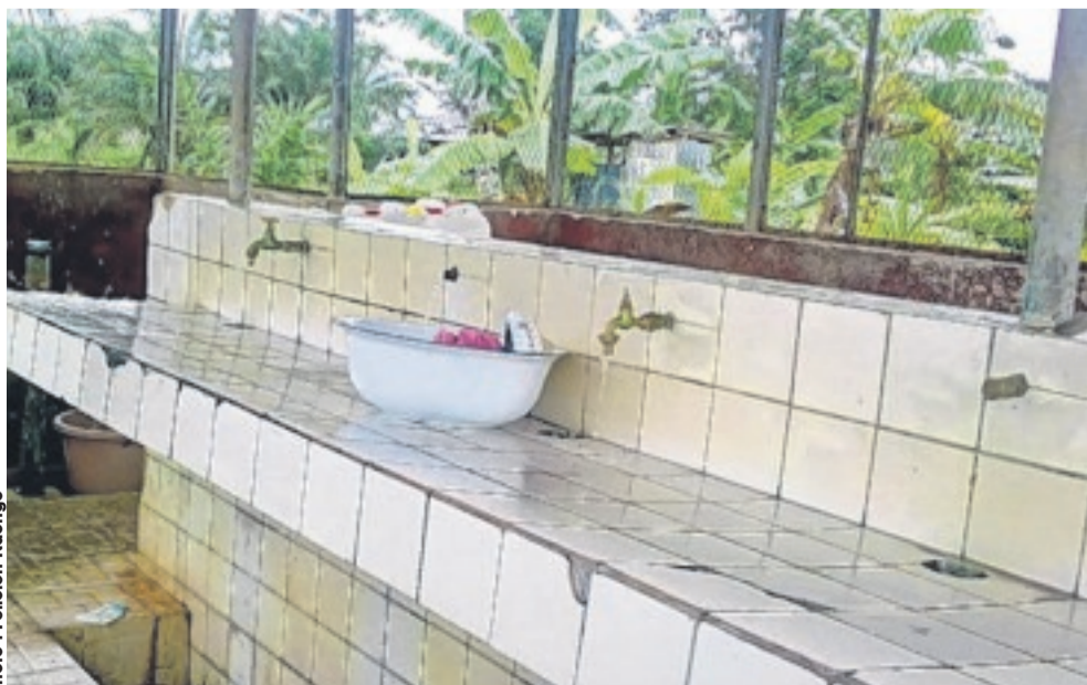
Le lavoir réalisé dans le cadre du projet des TIPPEE n'est pas utilisé à bon escient par les riverains.
