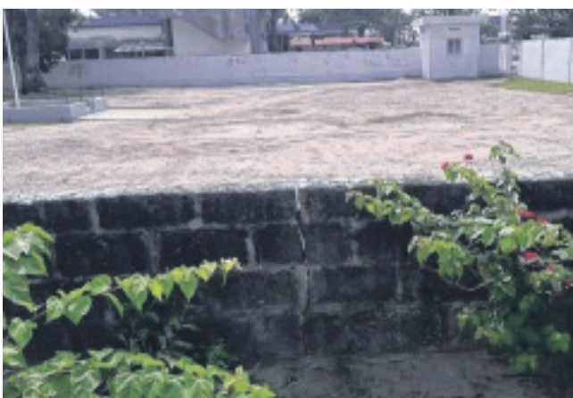
La barrière de la préfecture du département de Bendié, inachevée, se craquelle.
