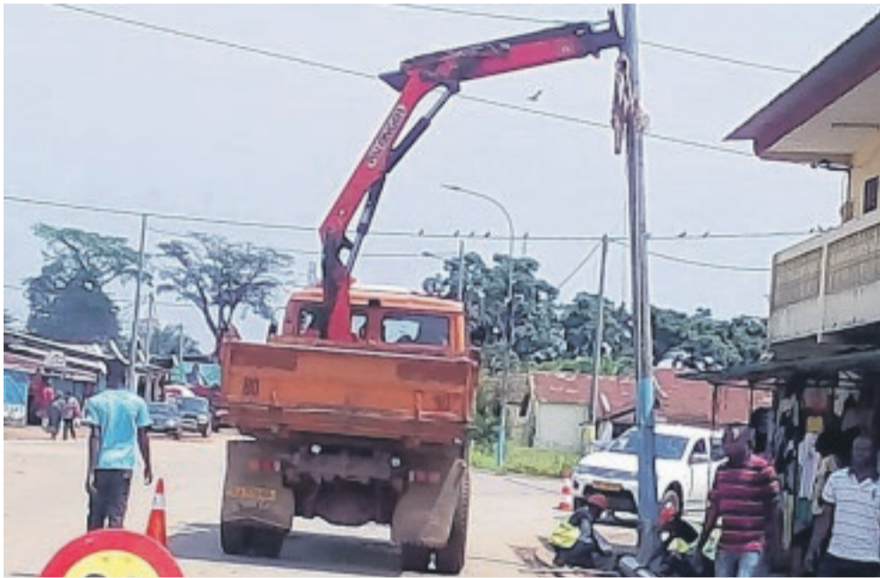
Le poteau métallique endommagé démantelé par une grue.
