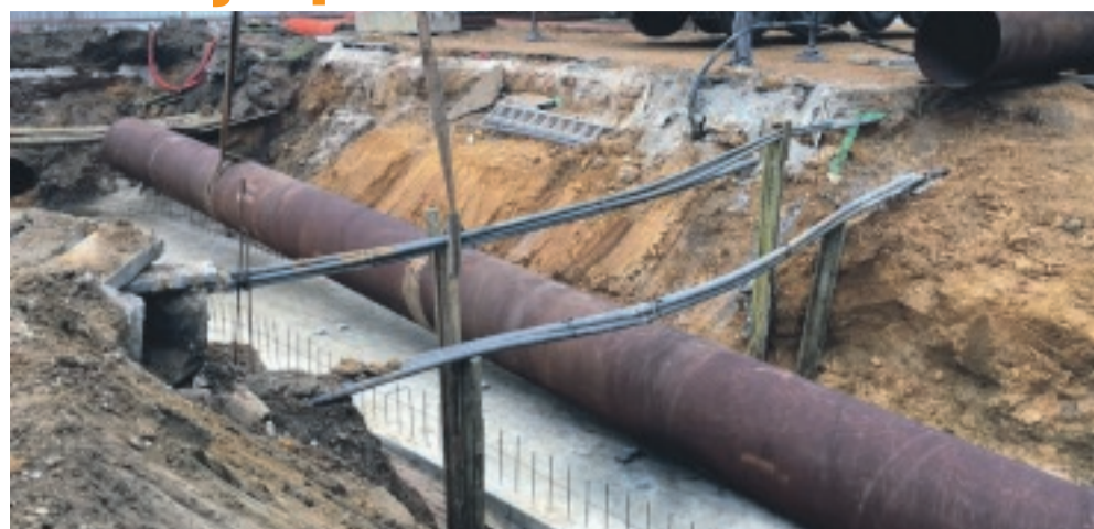
Les buses déjà posées par les travailleurs de Colas sur le chantier des Charbonnages.
