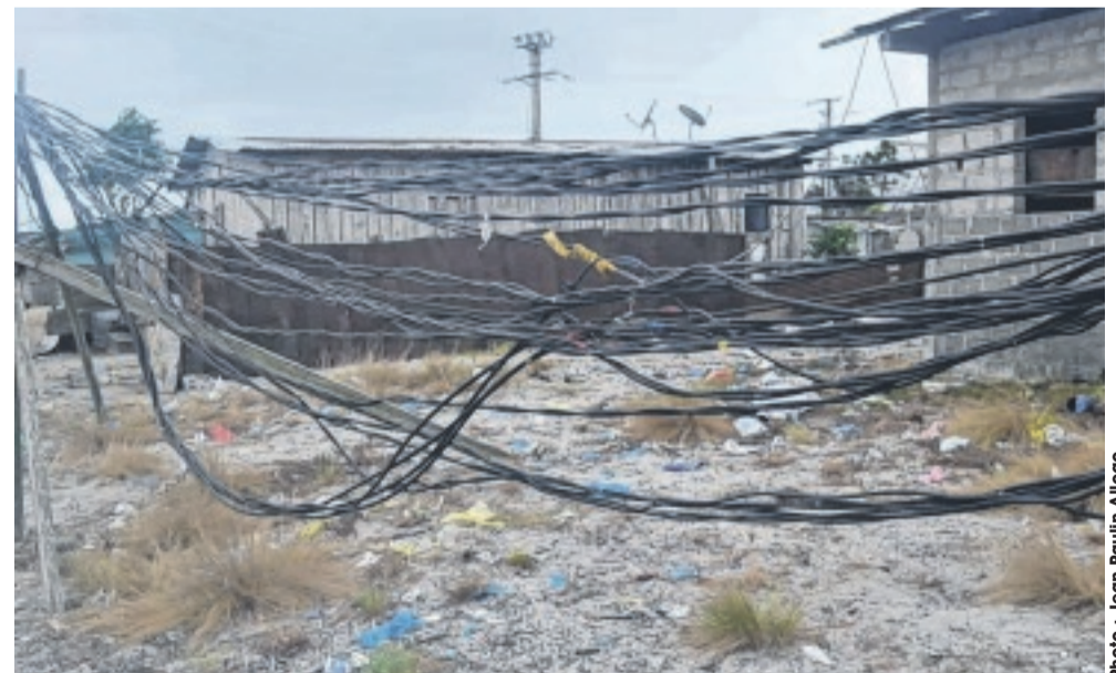
Des fils pendent dangereusement, comme ici, à plusieurs endroits de la ville.
