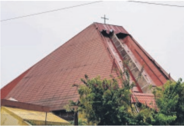
Une partie du toit de l'église Saint-Hilaire a été emportée par le vent.
