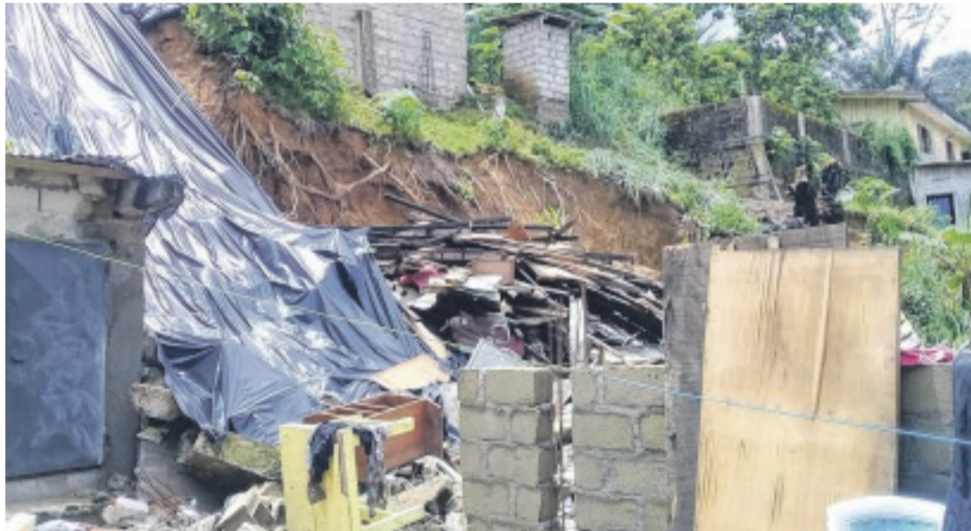
Le drame a été provoqué par un mur de soutènement construit en dessous de cette maison en dur.
