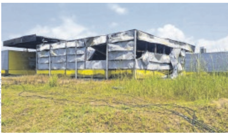
Le bâtiment sinistré.
