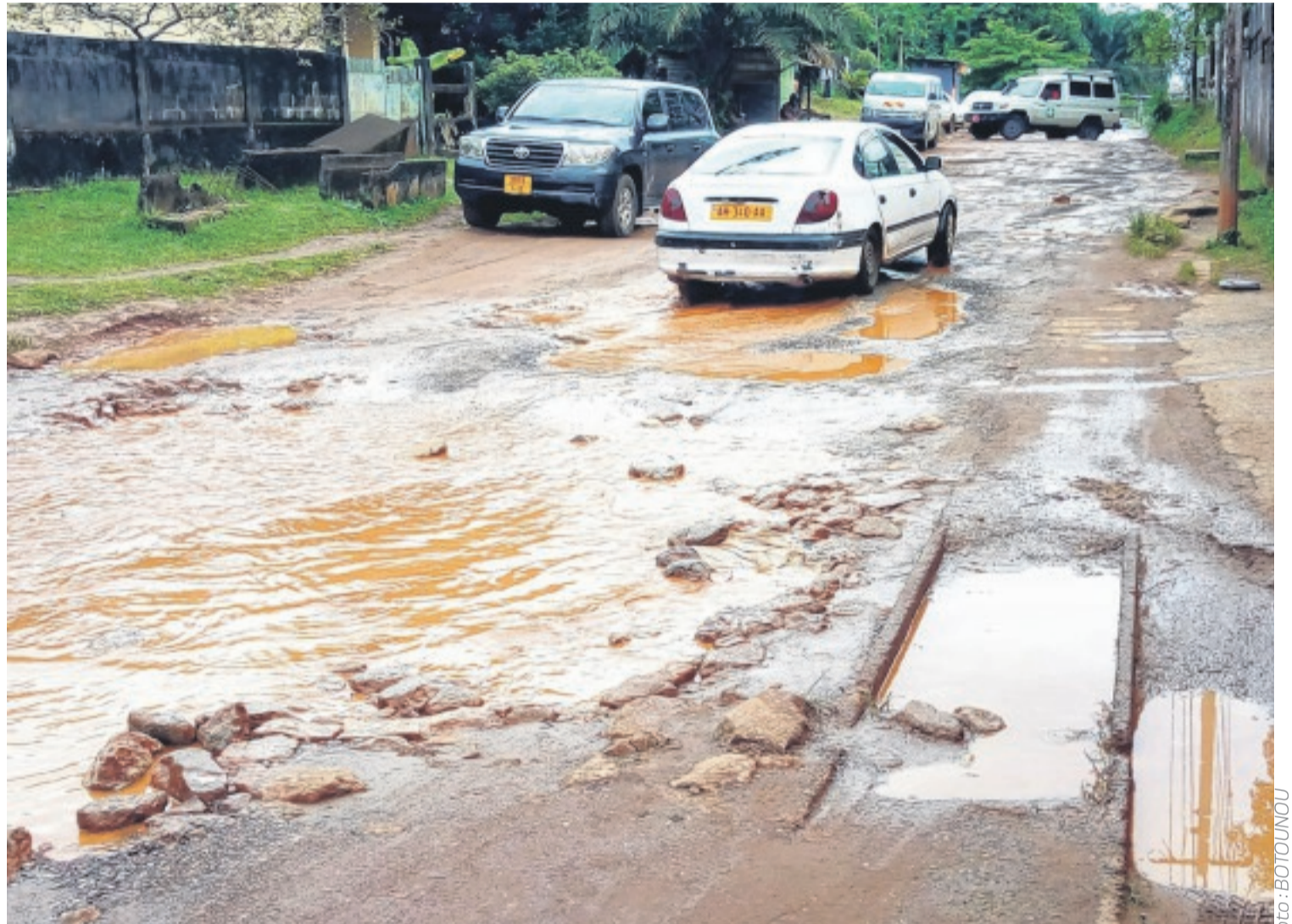
Des flaques d'eau le long de la voie : la situation de Derrière-l'ENS en saison des pluies n'est guère reluisante.
