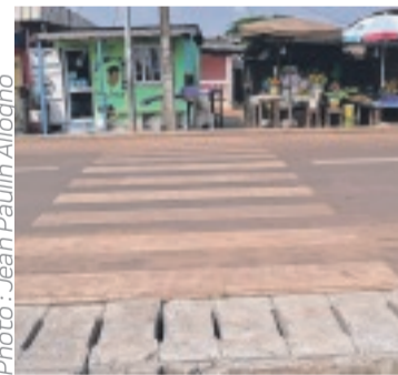
Vue d'une signalisation horizontale défraîchie.
