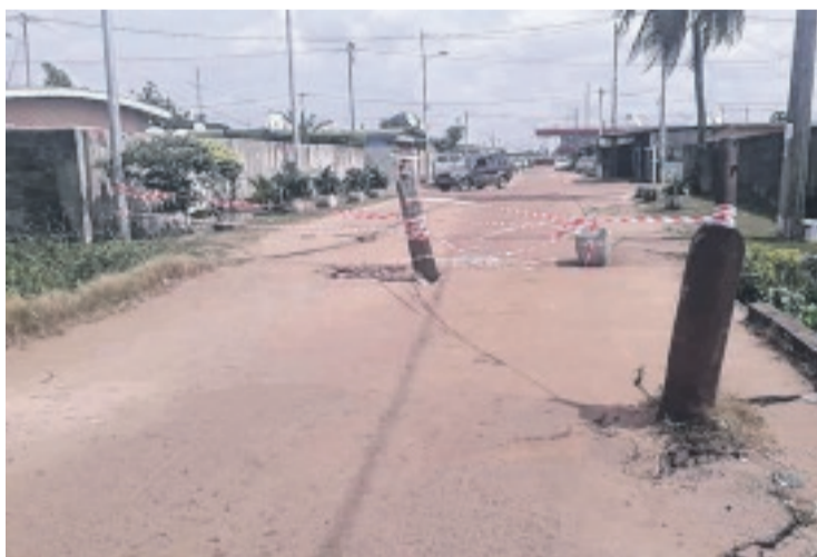
Une route barrée à cause de l'érosion.
