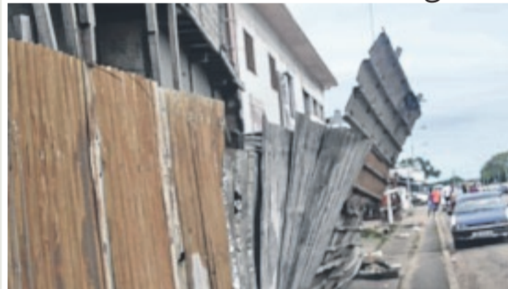
Vue de la barrière tôlée à problèmes.
