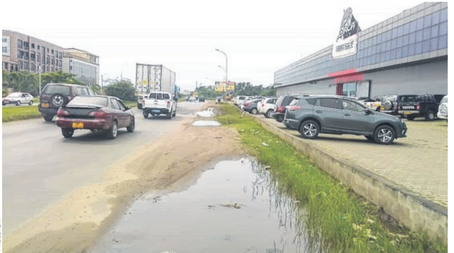
Devant le magasin Orca à Acaé, une partie de la chaussée est constamment inondée, faute de caniveau, et le trottoir absent.
