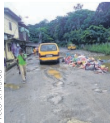
La dégradation de la route du quartier Venez-voir cause des désagréments tant aux usagers qu'aux riverains.
