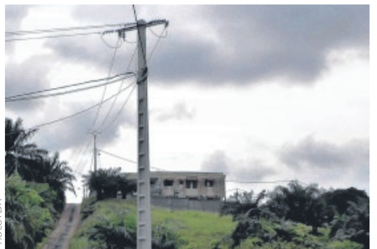
Poteau électrique de la SEEG à Igoumié.
