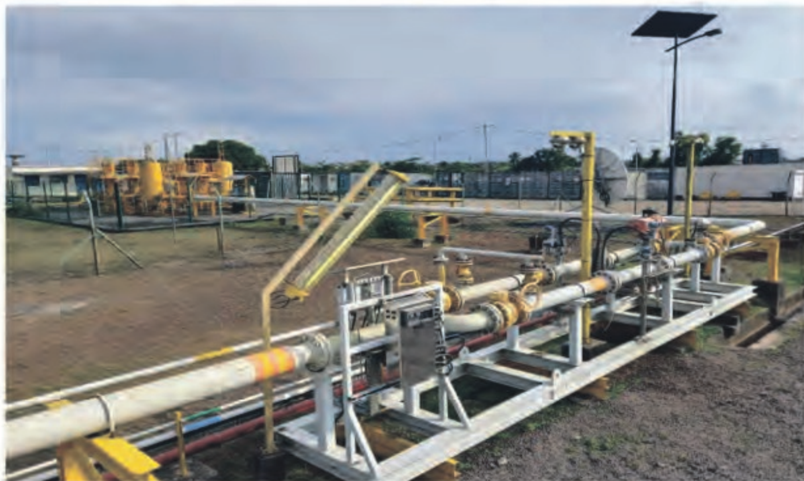
Pipeline PERENCO - Arrivée gaz à la Centrale Thermique SEEG d'Owendo
