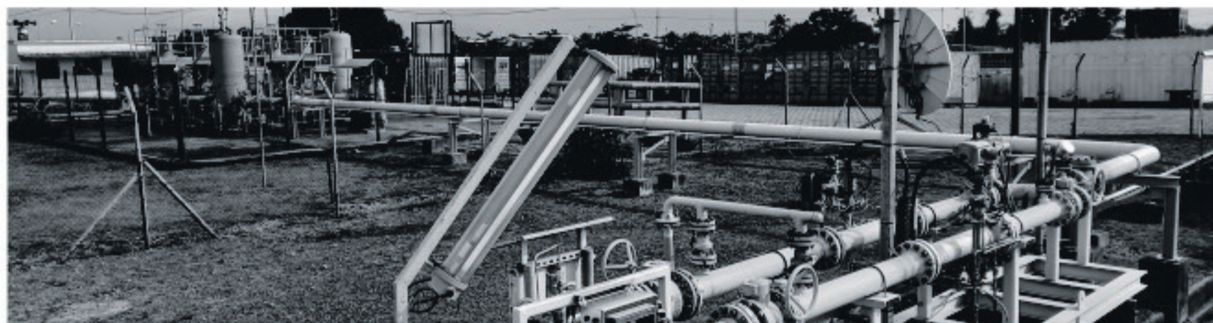
Pipéline PERENCO - Arrivée gaz à la Centrale Thermique SEEG d'Owendo
