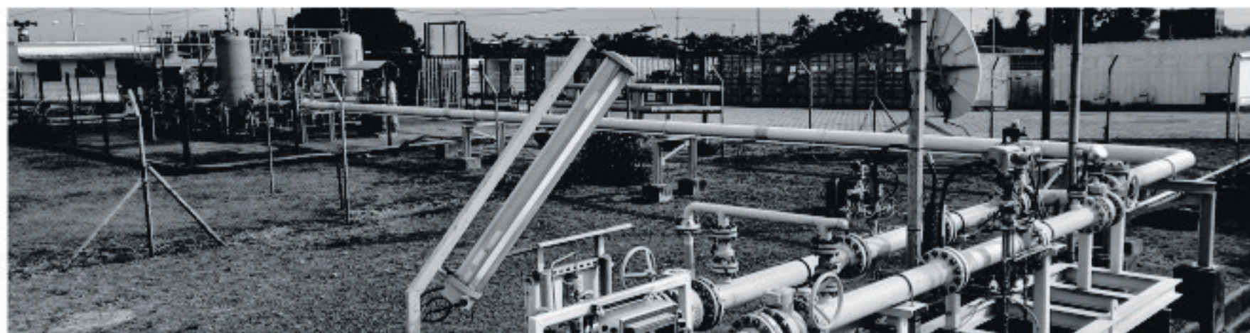
PipeLINE PERENCO - Arrivée gaz à la Centrale Thermique SEEG d'Owendo
