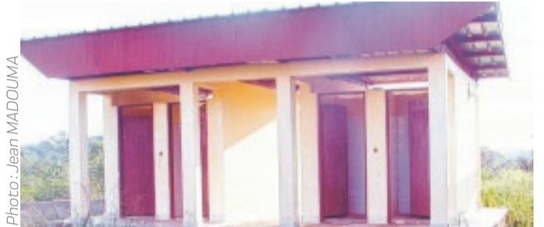
Exemple de latrines dans un établissement public. Tous devraient en disposer.
