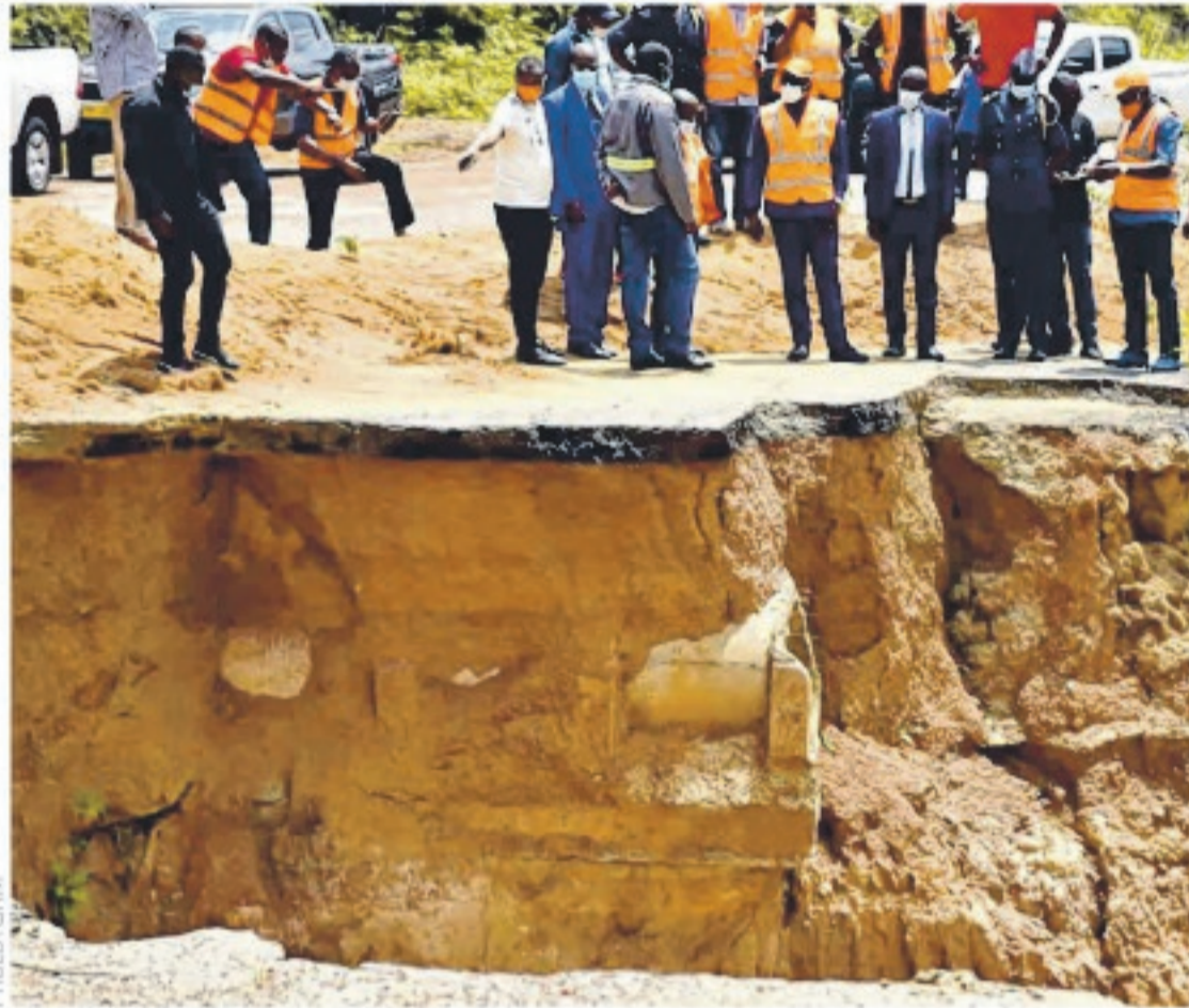
Un glissement de terrain menace de couper la route entre Mounana et Leyou.
