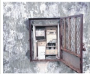
Vue d'un compteur électrique à moitié vandalisé.
