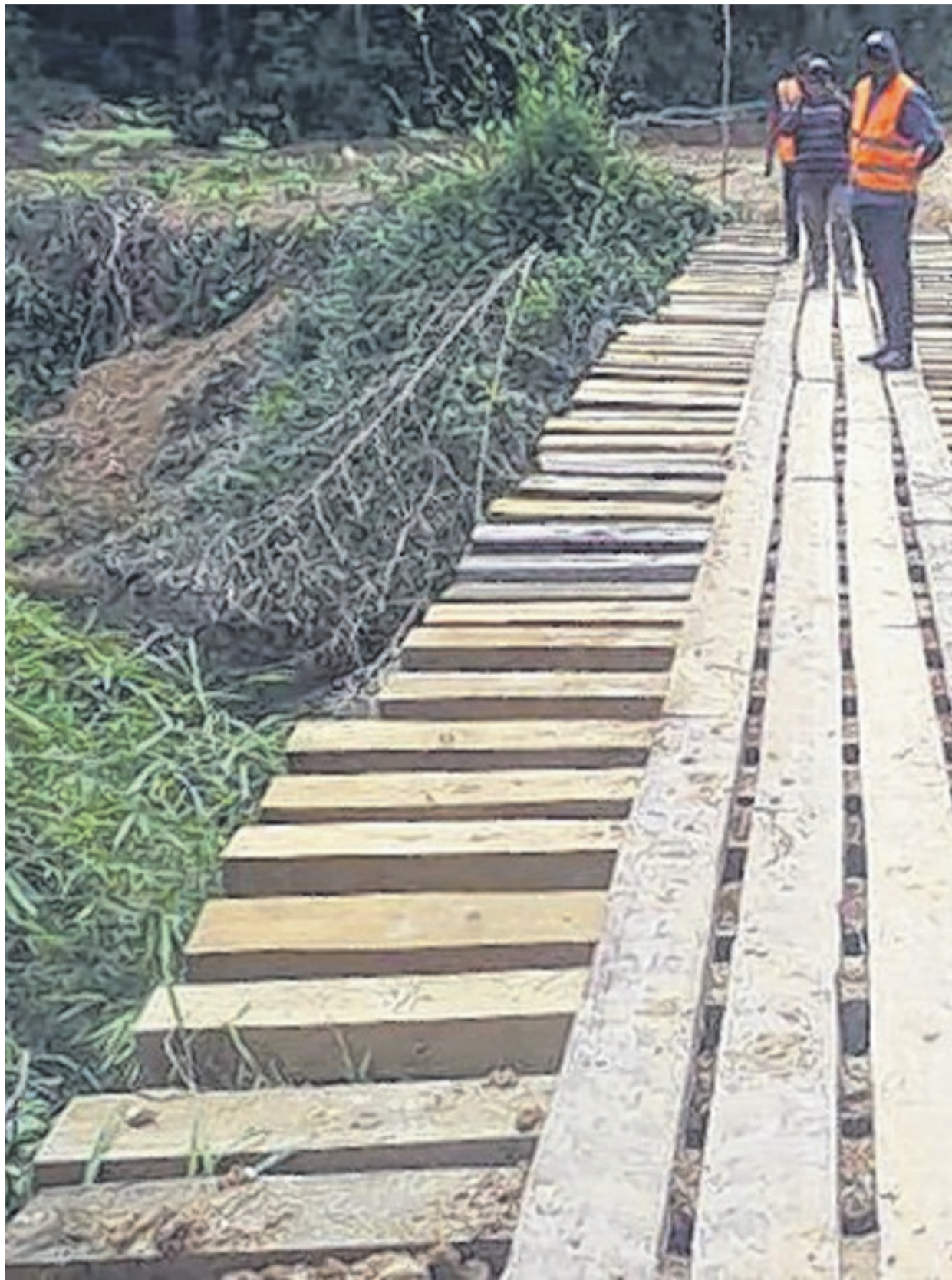
Longtemps resté défectueux, le pont sur la rivière Doufoufou a été réfectionné. A la grande satisfaction
